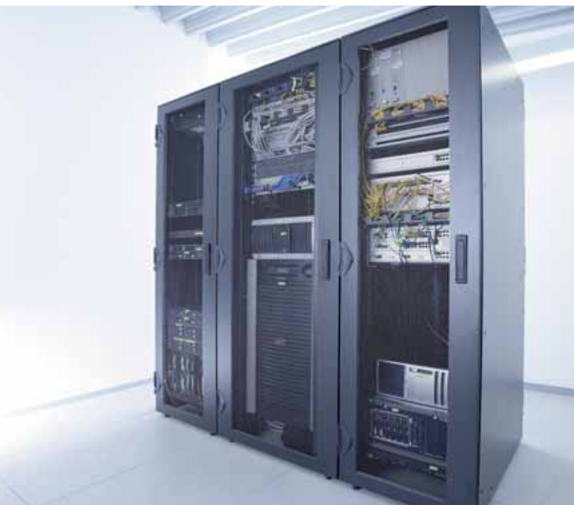
Technik kann auch schön sein – der Serverschrank verbindet edles Design und Funktion zu einem interessanten Objekt.
